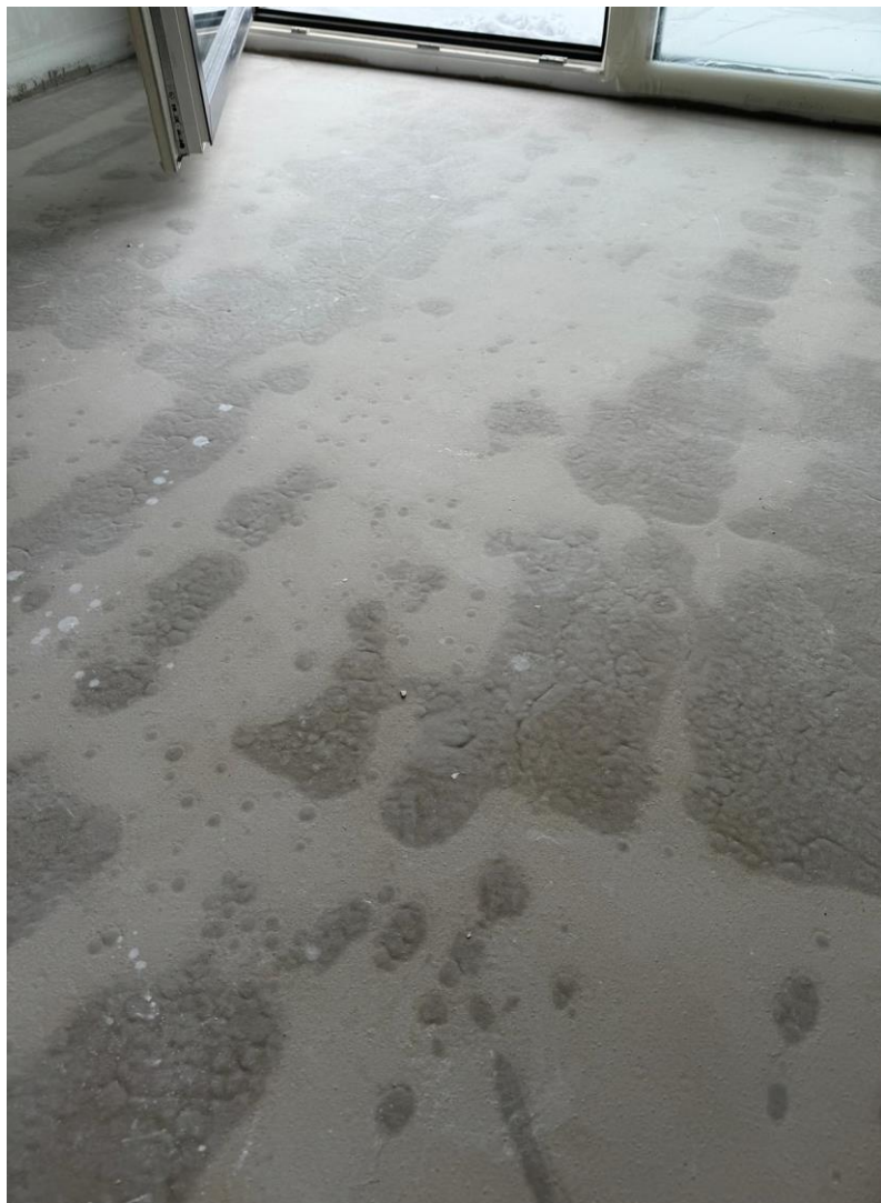
Špatná penetrace podkladu
