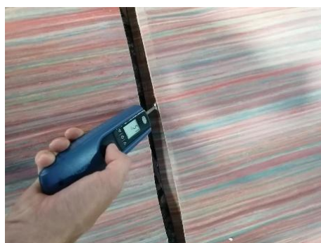
Opětovný přísun vlhkosti z betonového stropu
